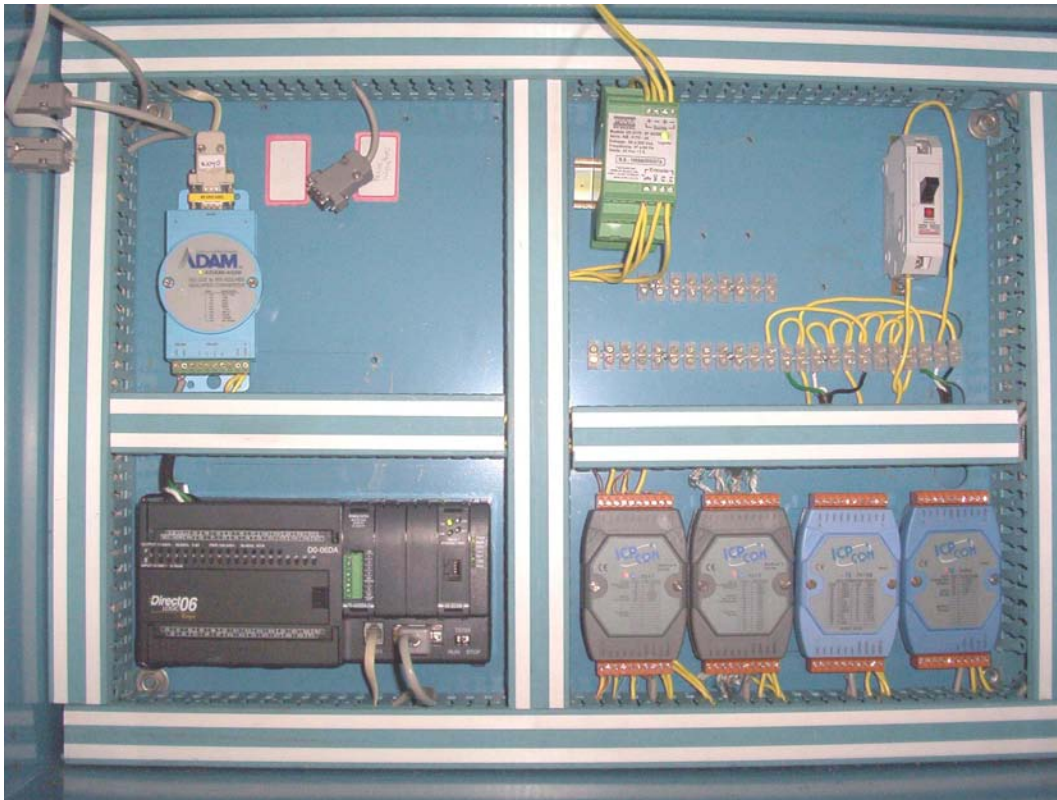
Figura 8.8: Vista interna del tablero de control
