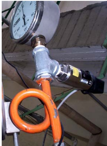
Figura 8.4: Sensor de presión instalado
