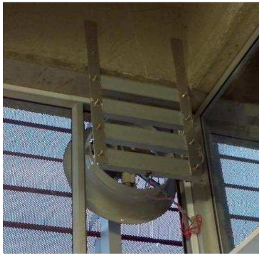
Figura A1.2. Resistencias disipadoras de corriente y sistema de ventilación para enfriarlas.
