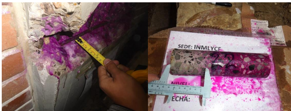
Figura 8. Ensayo de carbonatación utilizando fenolftaleína.
