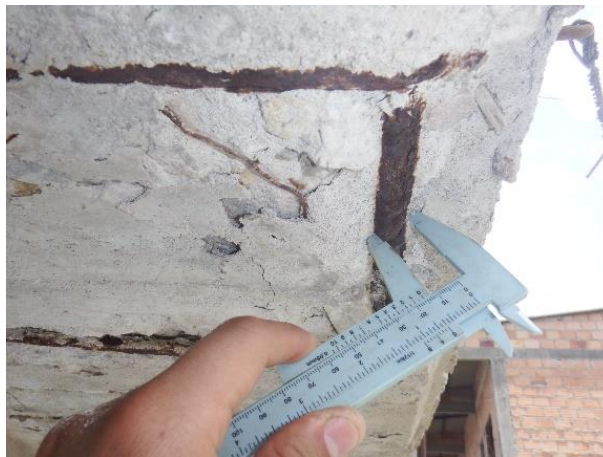
Figura 9. Oxidación del acero de refuerzo causada por el desprendimiento y carbonatación del concreto.
