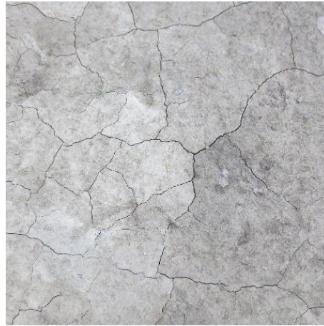
Figura 7. Degradación del concreto por expansión y fisuración ocasionada por el ataque de los sulfatos.
