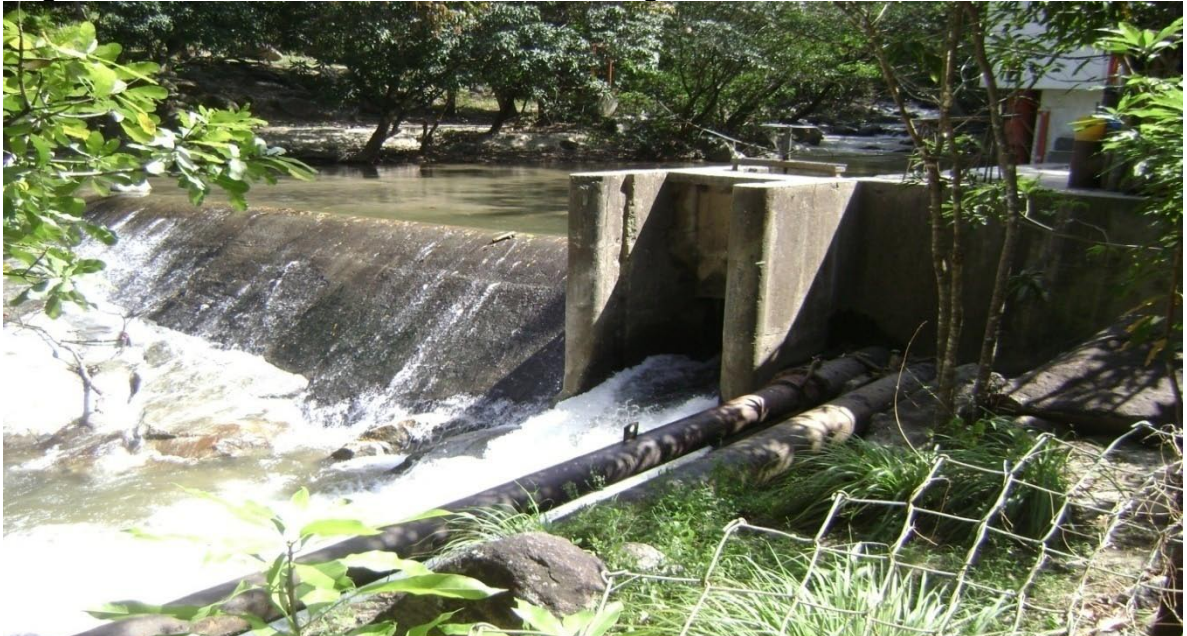
Figura 36: Boca toma Paso del Mango, Acueducto Santa Marta. Fuente: Lorena Aja Eslava, 2006..
