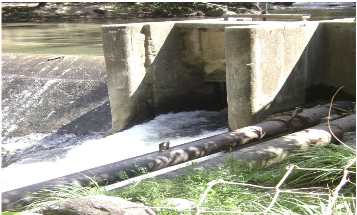
Figura 7: Boca toma acueducto Santa Marta, Paso del Mango. Fuente: Lorena Aja Eslava, 2006.
