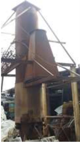
Figura 5-3 Horno Cubilote de BRONALCO (Plano y Fotografía), Fuente: BRONALCO LTDA.
