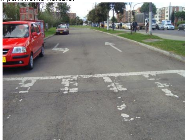
Foto 4-7: Descaramiento en pavimento flexible.
