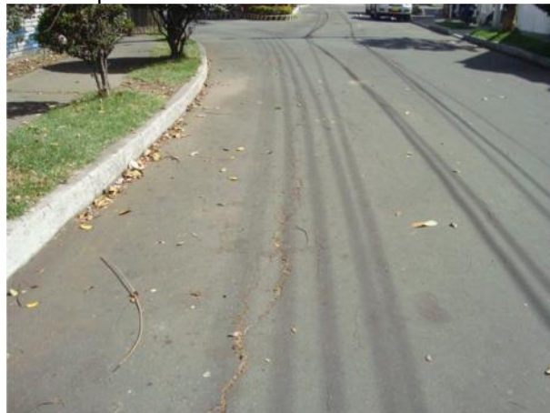
Foto 4-2: Fisura longitudinal en pavimento flexible.
