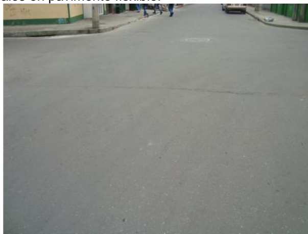
Foto 4-4: Fisuras transversales en pavimento flexible.
