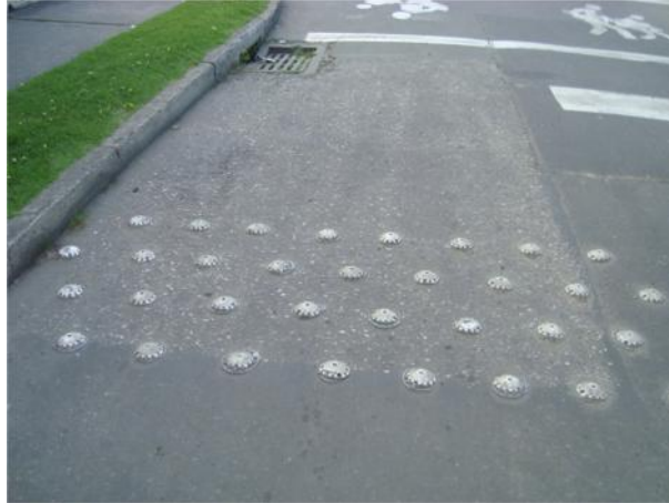
Foto 4-8: Pulimento de agregados en pavimento flexible.
