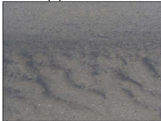
Foto 4-9: Exudación en pavimento flexible [27].
