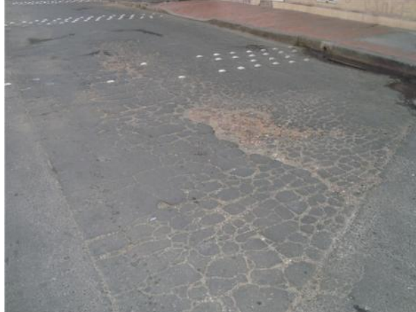
Foto 4-3: Piel de cocodrilo en pavimento flexible.
