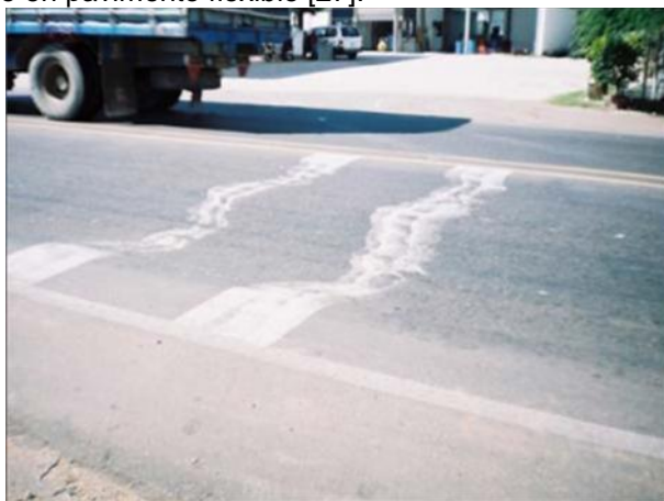
Foto 4-1: Ahuellamiento en pavimento flexible [27].
