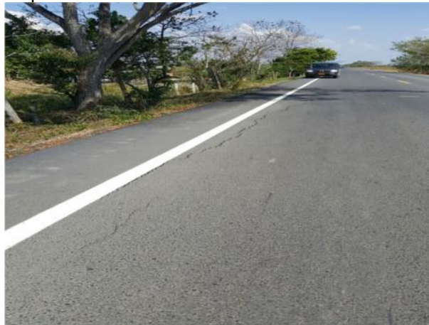
Foto 4-5: Fisuras de borde en pavimento flexible.
