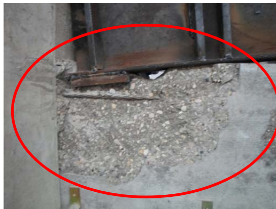
Figura 42. Falla por aplastamiento en la losa alveolar extremo izquierdo
