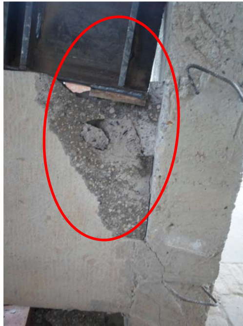
Figura 43. Falla por cortante en la junta extremo derecho
