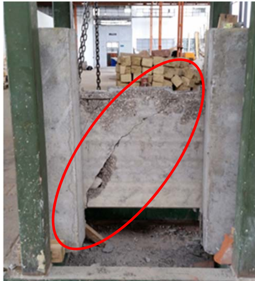
Figura 45. Falla por tensión diagonal en la losa alveolar
