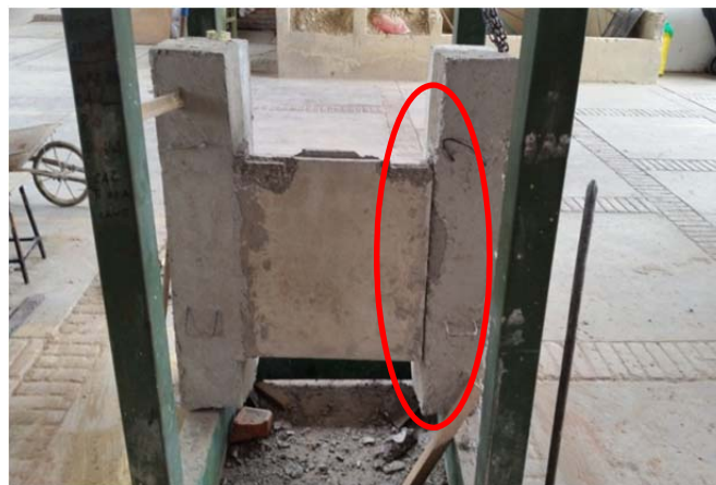
Figura 46. Falla por cortante en la junta
