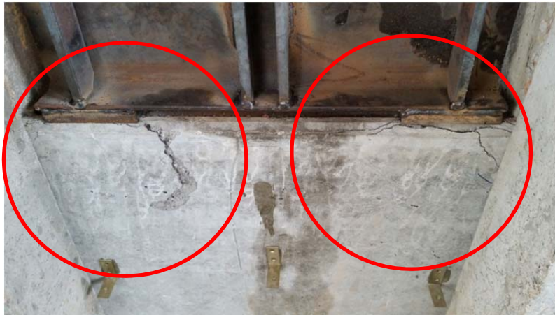
Figura 51. Concentración de esfuerzos en zona de aplicación de la carga.
