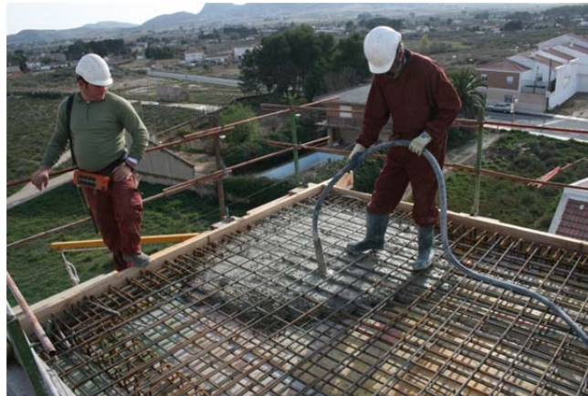
Figura 3 Entrepiso en losa maciza (Fuente: Centro de Información, Innovación y Recursos Educativos de Elda)
