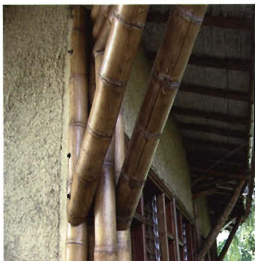
Figura 7. Elementos de guadua con grietas longitudinales por mal secado Foto. Alexander Osorio. 2006)
