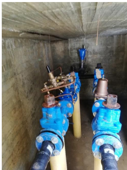
Ilustración 8: Estación de regulación Cuchilla del Salado (Elaboración propia, 2020)
