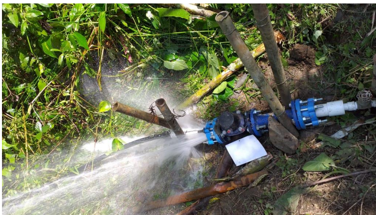
Ilustración 1: Fuga de en la red de acueducto de la zona rural (Elaboración propia, 2020)
