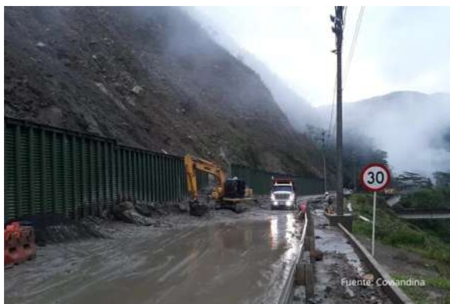
Fotografía 17. Zona de deslizamiento Vía Bogotá – Villavicencio Km 58 Fuente: COVIANDINA en Universidad de los andes (2023)
