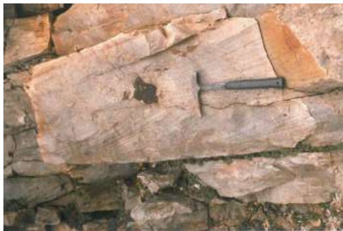
Fotografía 1. Taqueo o taco ubicado en bloque
