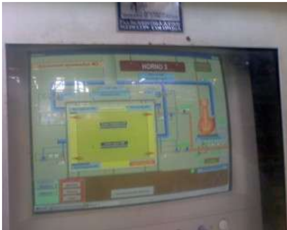
Figura 4.42. Dispositivo de control del horno del grupo CORONA.
