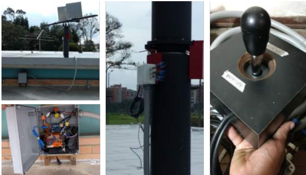
Figura 3-13.: Tablero de potencia de motores, caja de distribución y Joystick.
