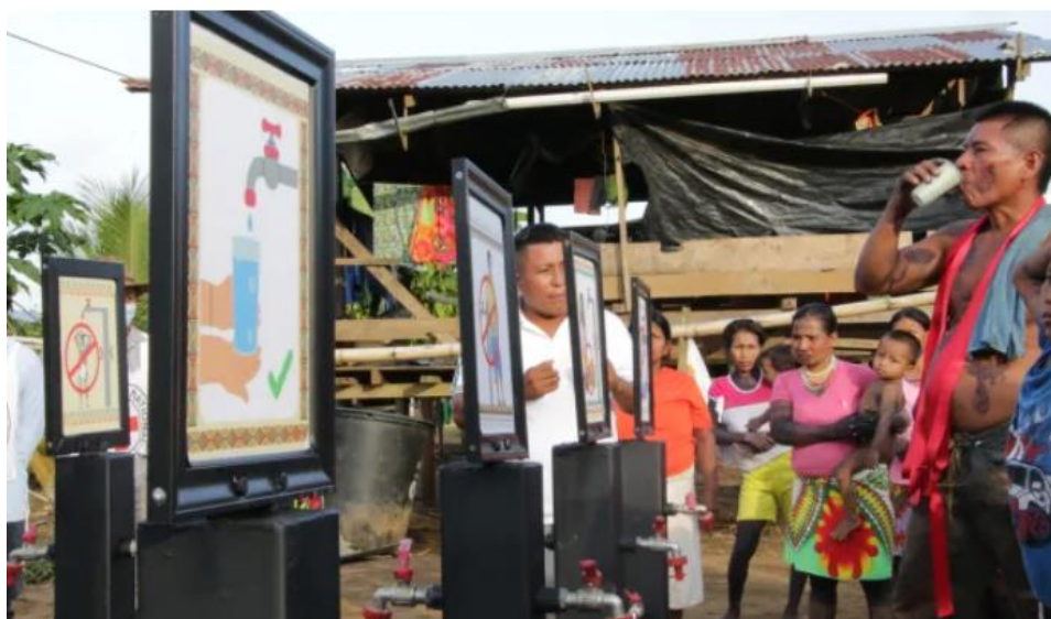
Figura 6. Torres de agua potable instaladas en la comunidad de Peñas Blancas, Chocó Fuente: Jaramillo and CICR (2022)
