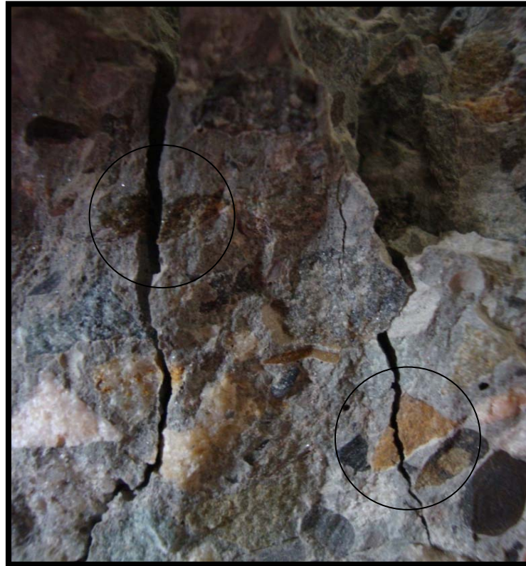
Fotografía 15. Fisura del concreto de alto desempeño
